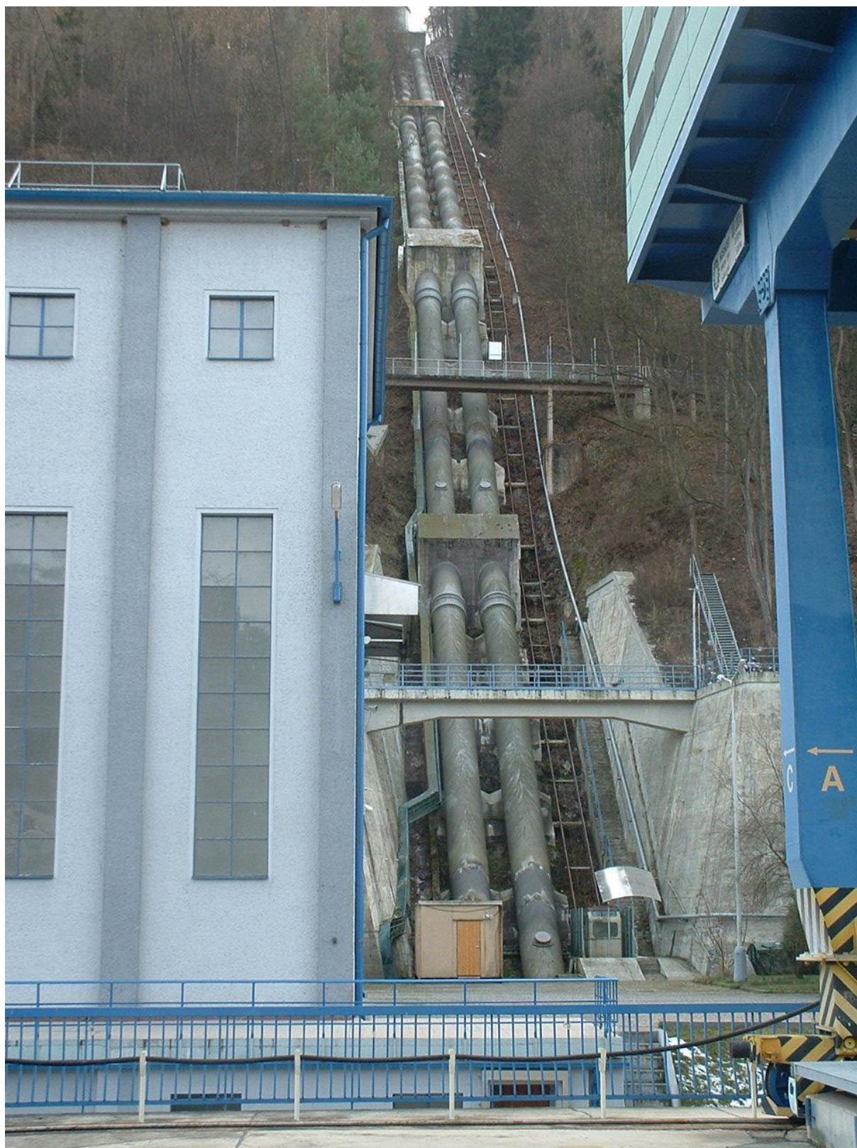
Přivaděčové potrubí z nádrže Homole – Štěchovice II
