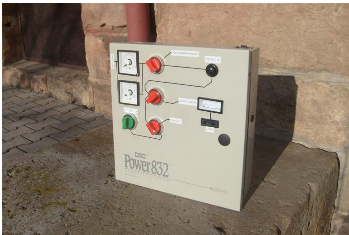
Obr. 19 – Odpojený řídicí panel
