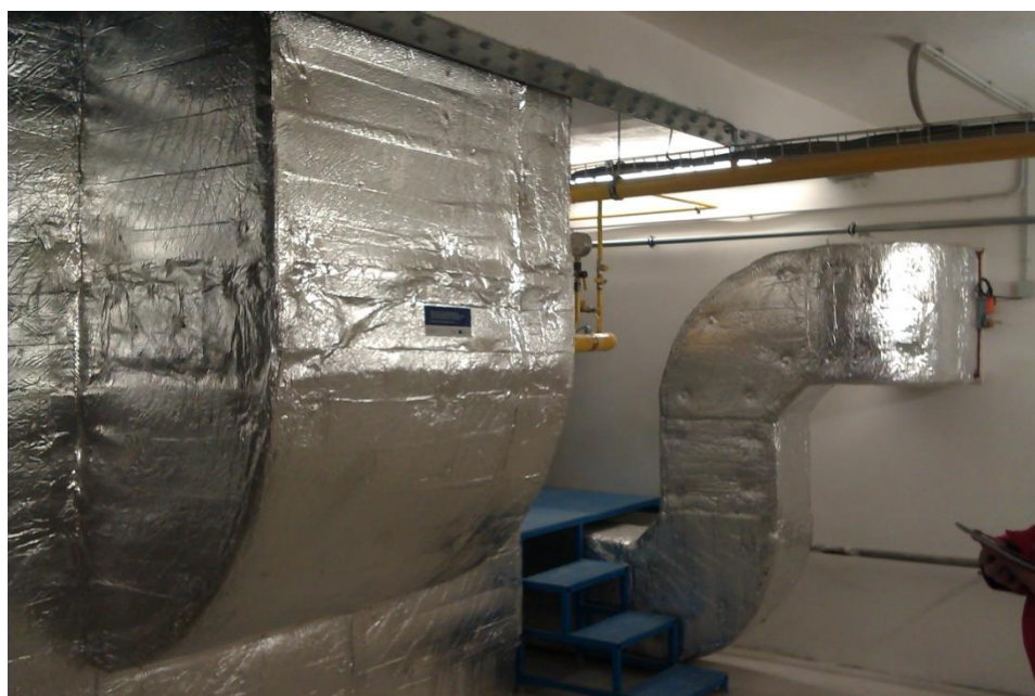
Obr. 18: Izolované vzduchovody na hvozdu
