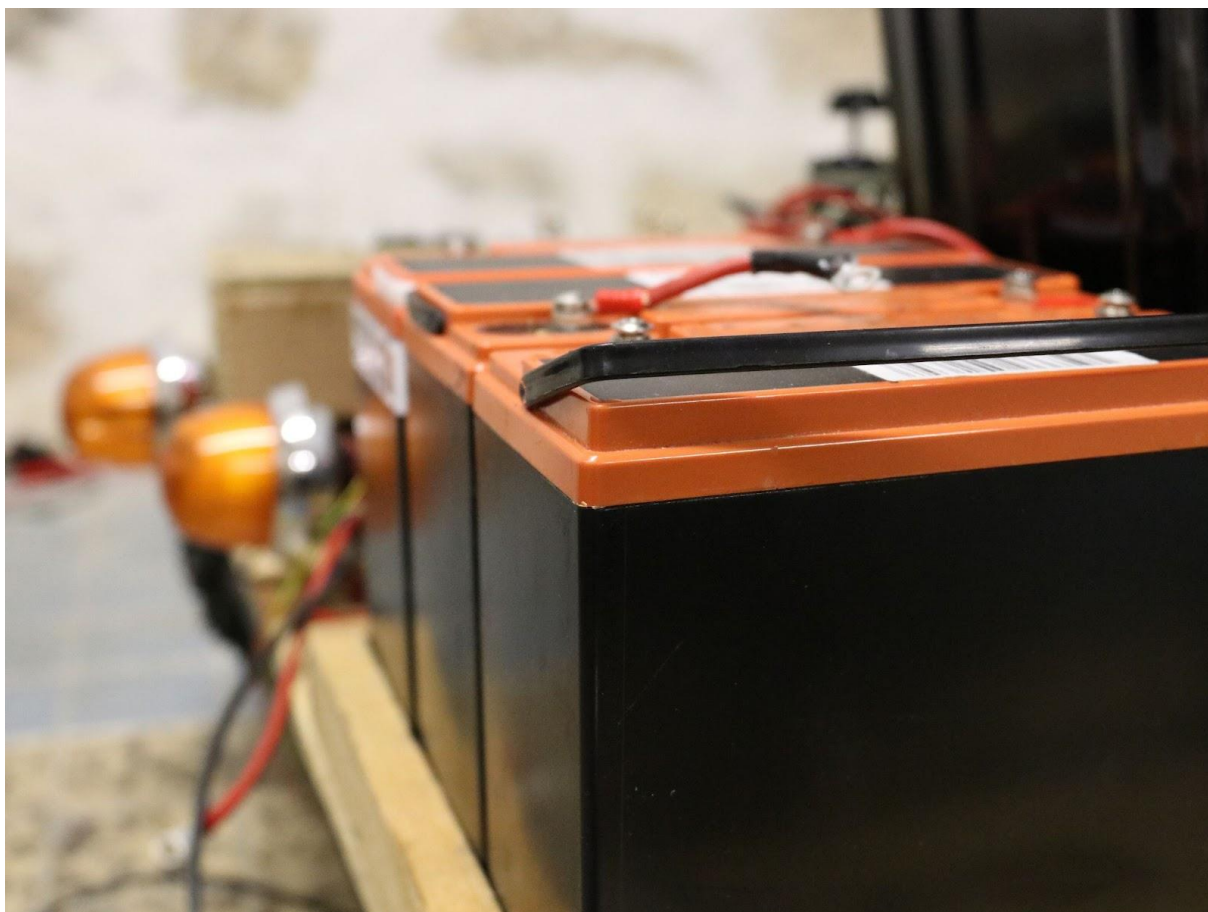
Obr. 7: Trakční baterie 36 V obvodu
