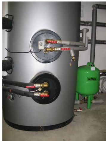
Obr. 11: Akumulační nádrž na TUV
