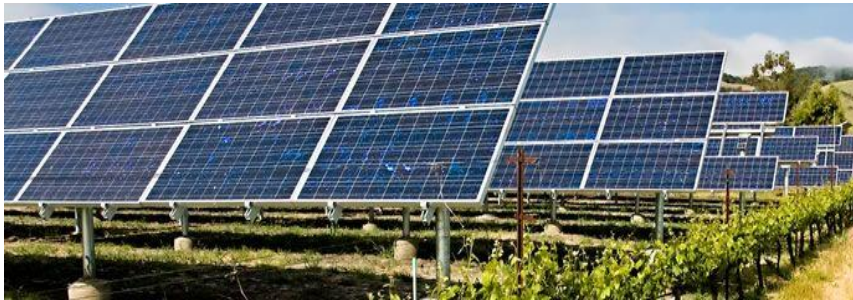
Fotovoltaická solární elektrárna
