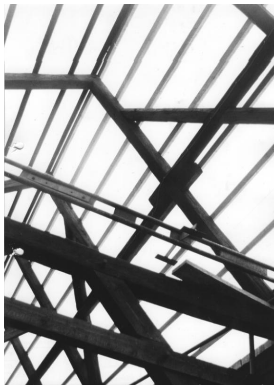
Obr. 18 – Radošovský most před požárem - fotografie
