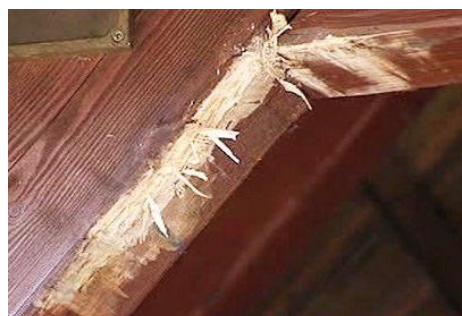
Obr. 22 - Radošov poškození automobilem - fotografie
