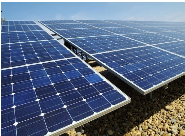
obrázek č. 13 - solární panely
