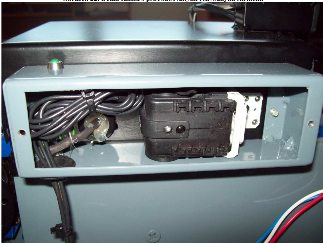
Obrázek 23: Pohled do rozvodné skříně na pravé straně
