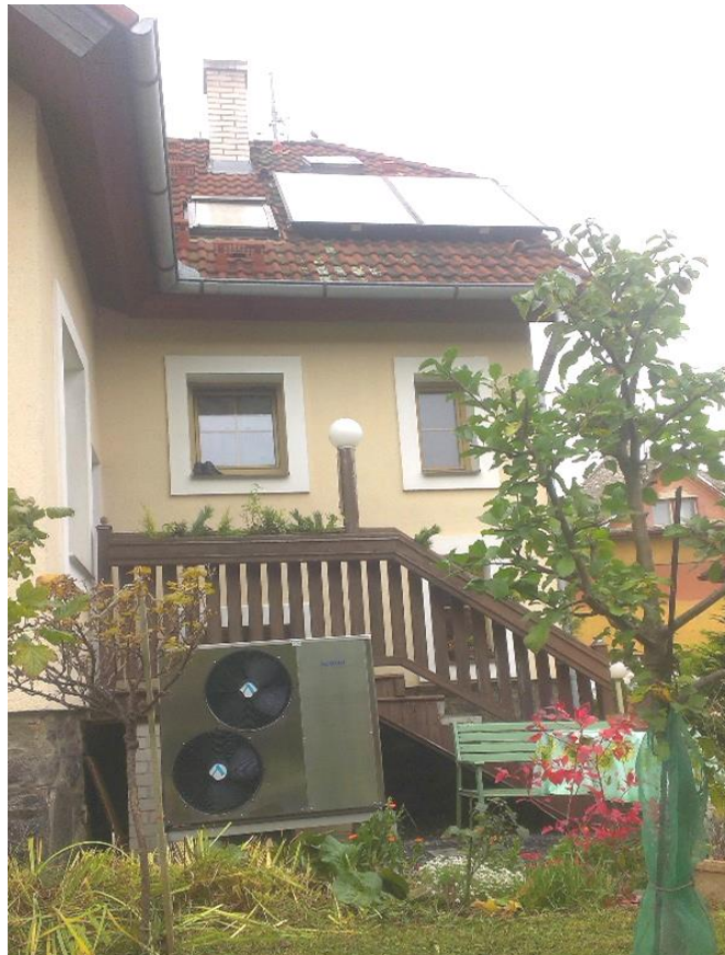
Obr. 4: Venkovní jednotka tepelného čerpadla ACOND12 vzduch/voda a solární kolektory pro ohřev vody na střeše domu Ing. Prokopa
