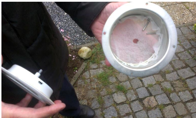
Obr. 7: Osazení sacího otvoru s textilním filtrem
