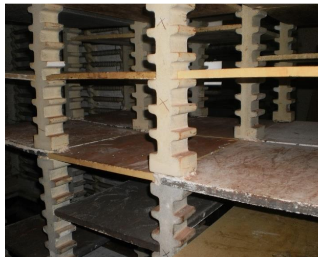
Obr. 7 Vnitřek elektrické pece
