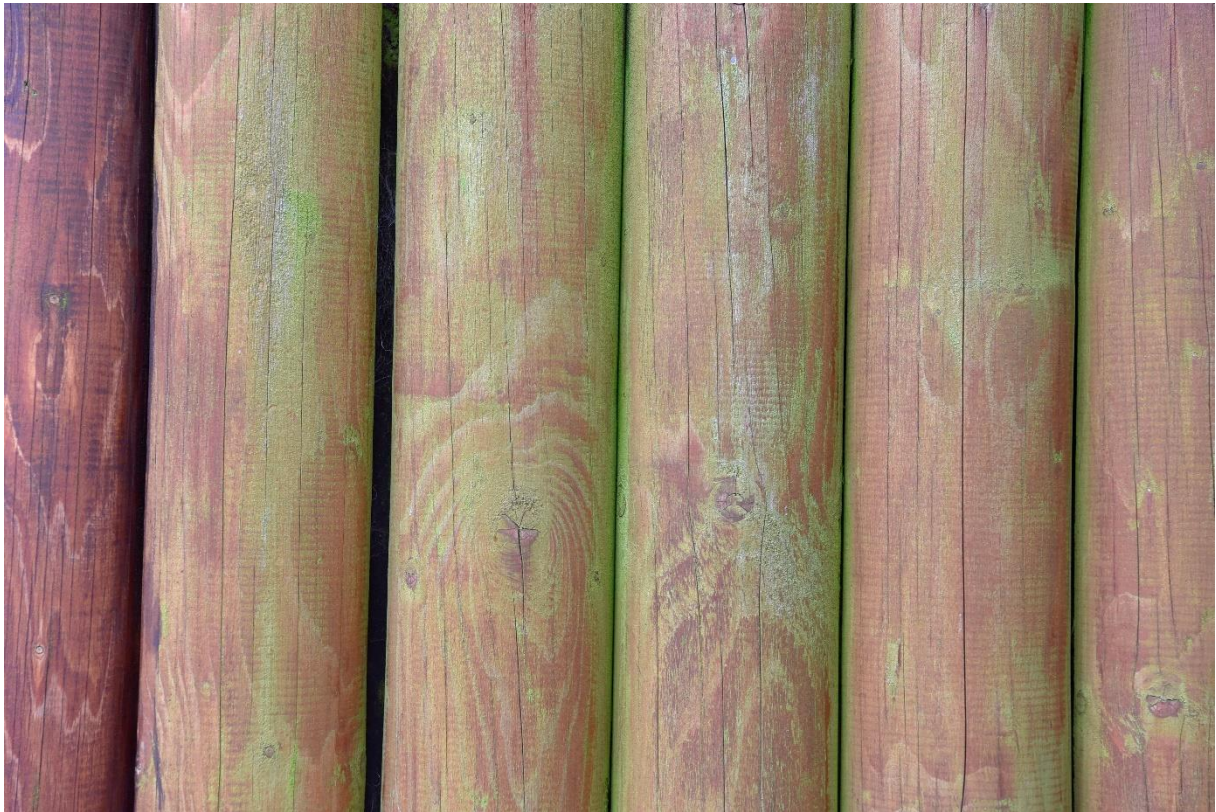
Obrázek 8: Řasy na dřevěné konstrukci
