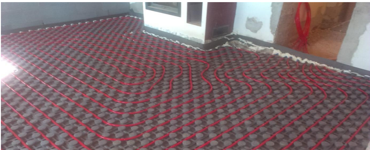
Obrázek 8: Polystyrénové nopové systémové desky s instalovaným plastovým potrubím u krbu[12]
