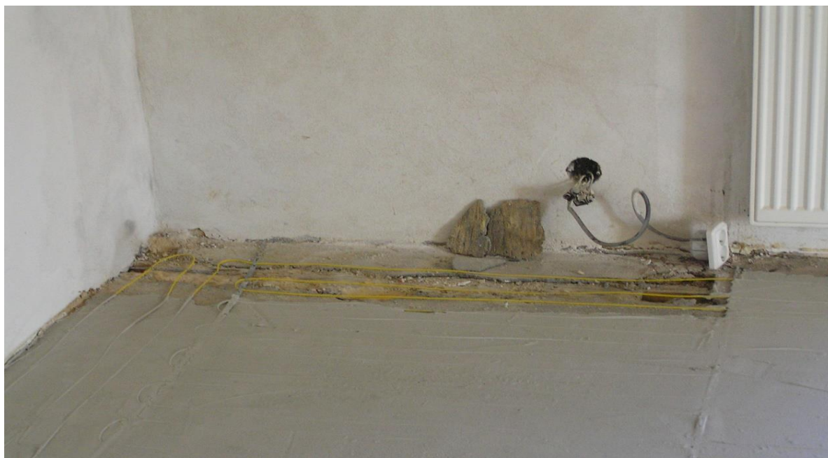
Obrázek 13: Obnažená část odporového drátu a jeho zapuštění do betonové mazaniny [12]
