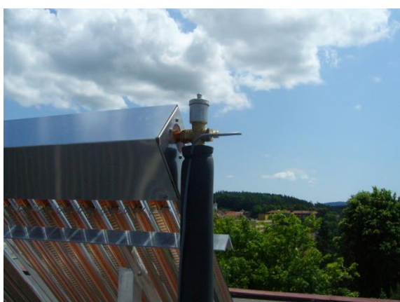
Obr. 12: Panely - čidlo teploty a pojistný ventil
