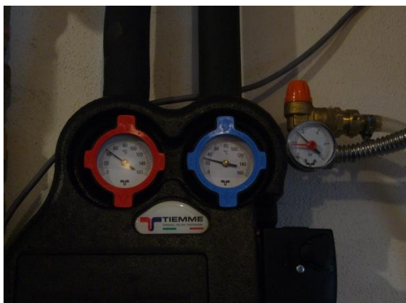
Obr. 18: Výměník - jednotka s teploměry
