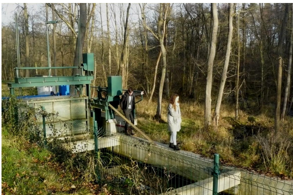
Obr. 10: Stavidlo umístěné mezi hrubými a jemnými česlemi [2]
