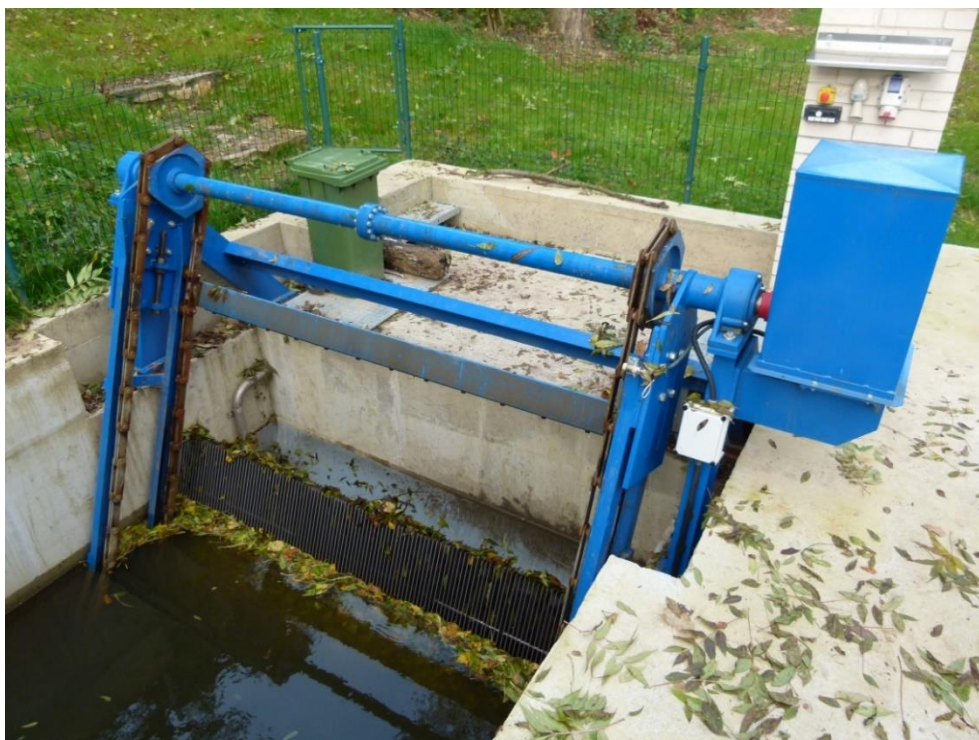
Obr. 9: V česlovně jsou jemné česle s automatickým čistícím strojem česlí. [1]
