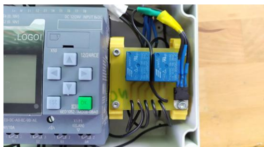
Obr. 14: Relé se stabilizátorem ve skřínce simulátoru
