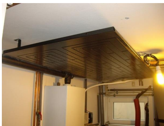
Obrázek 10 Termodynamický panel v interiéru [16]
