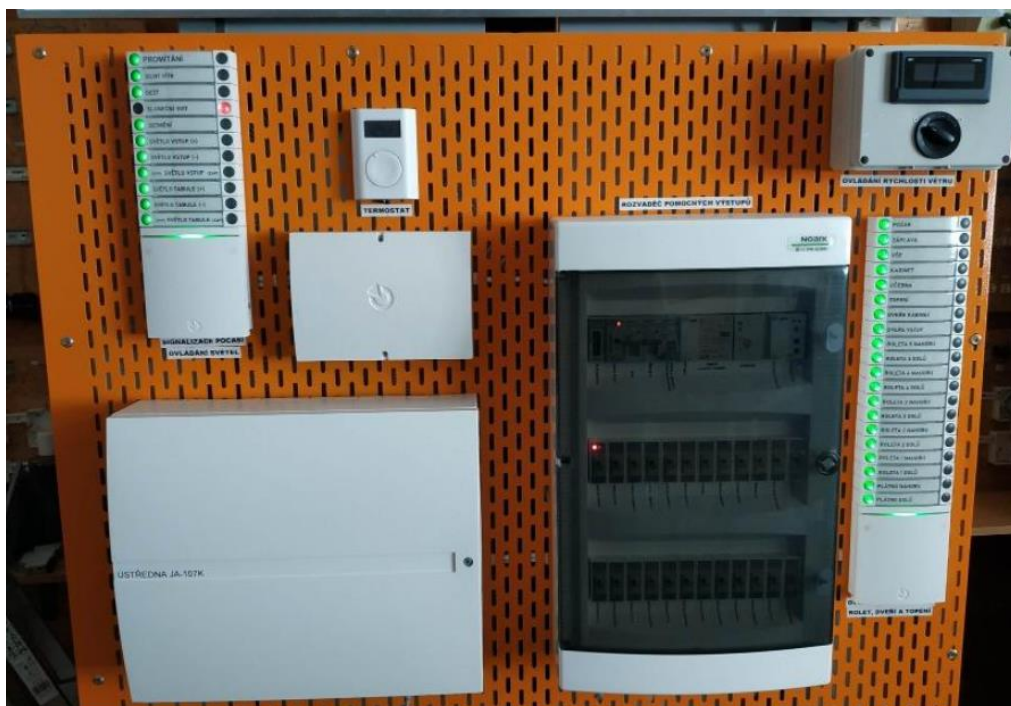
Obrázek 21: Panel zabezpečovacího systému Jablotron
