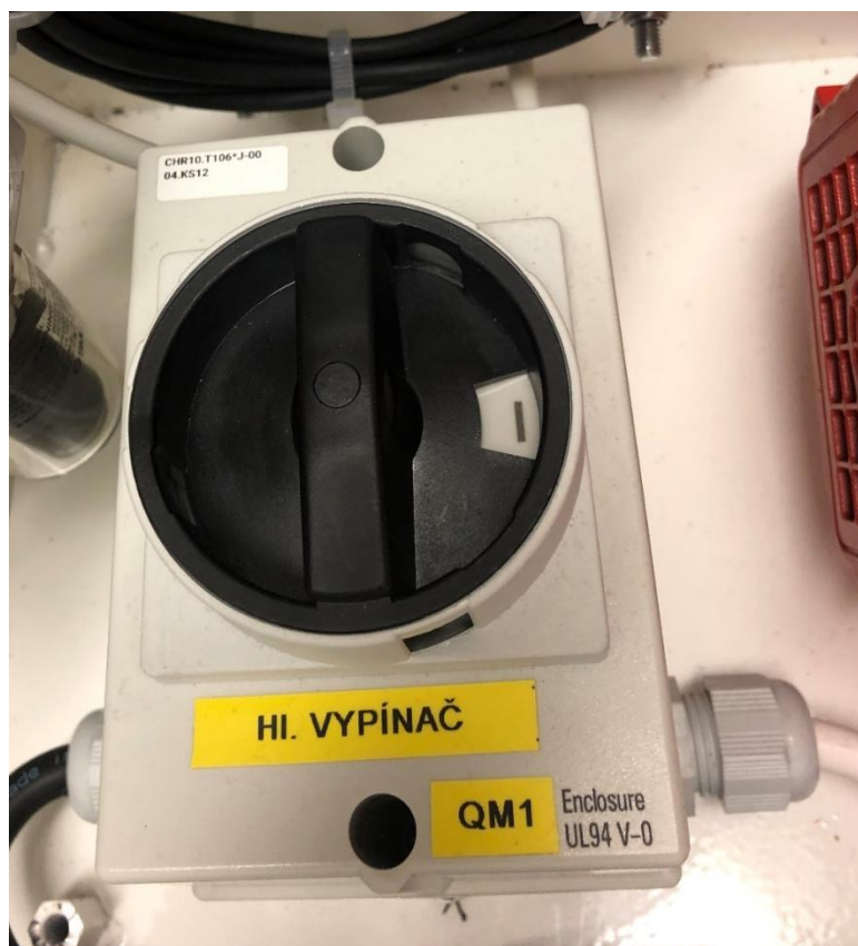
Obrázek 1- Hlavní vypínač; Zdroj: Autor
