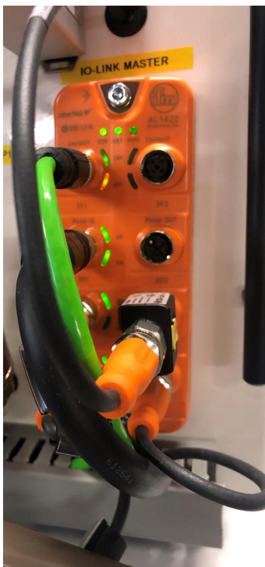
Obrázek 17 - Switch; Zdroj: Autor
