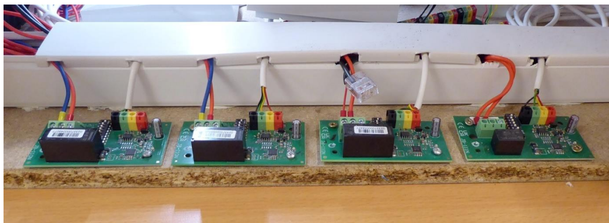
Obrázek 1 – Relé pro řízení čerpadel a osvětlení
